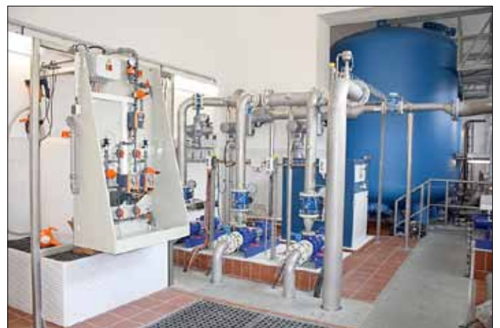
Dosieranlage und Filterstrecke in Jänschwalde-Ost
