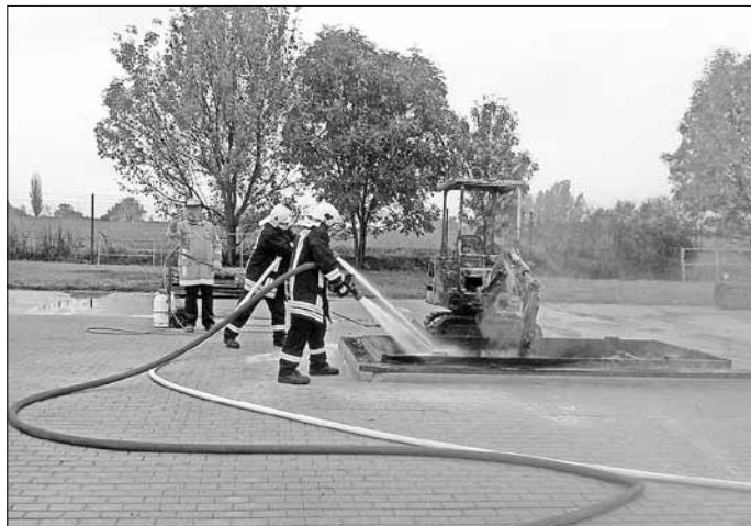
Bekämpfung eines Gasbrandes bei Beschädigung einer Mittel-druckleitung
