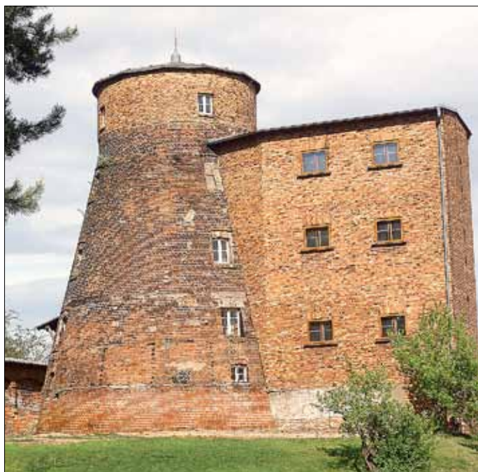
Zum Erhalt der Mühle wird derzeit der Fuß trockengelegt und das Mauerwerk saniert.
