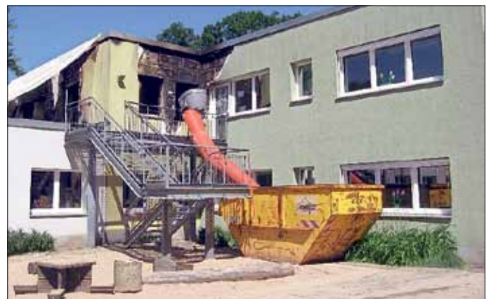
Blick auf den zerstörten Gebäudeteil.
